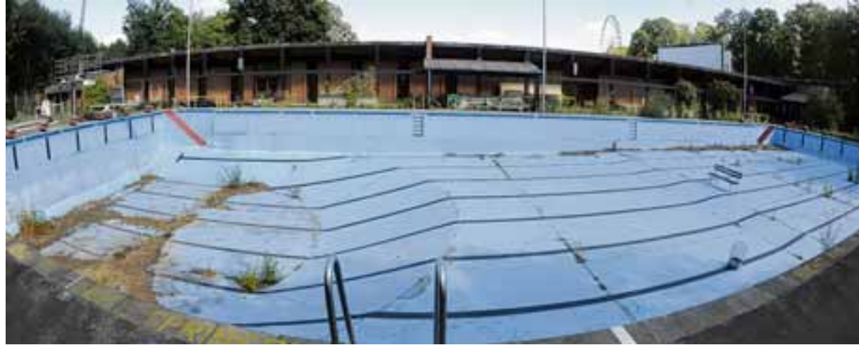
Das Sportbad hat schon deutlich bessere Zeiten erlebt. Seit vier Jahren steht es inzwischen leer und verfällt zusehends. Ob und wann das Freibad saniert wird, steht in den Sternen.
